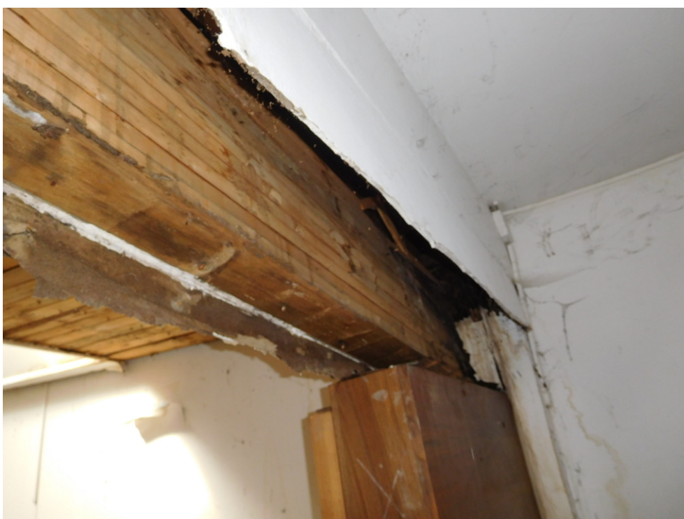
Pohled na staticky narušený dřevěný průvlak
