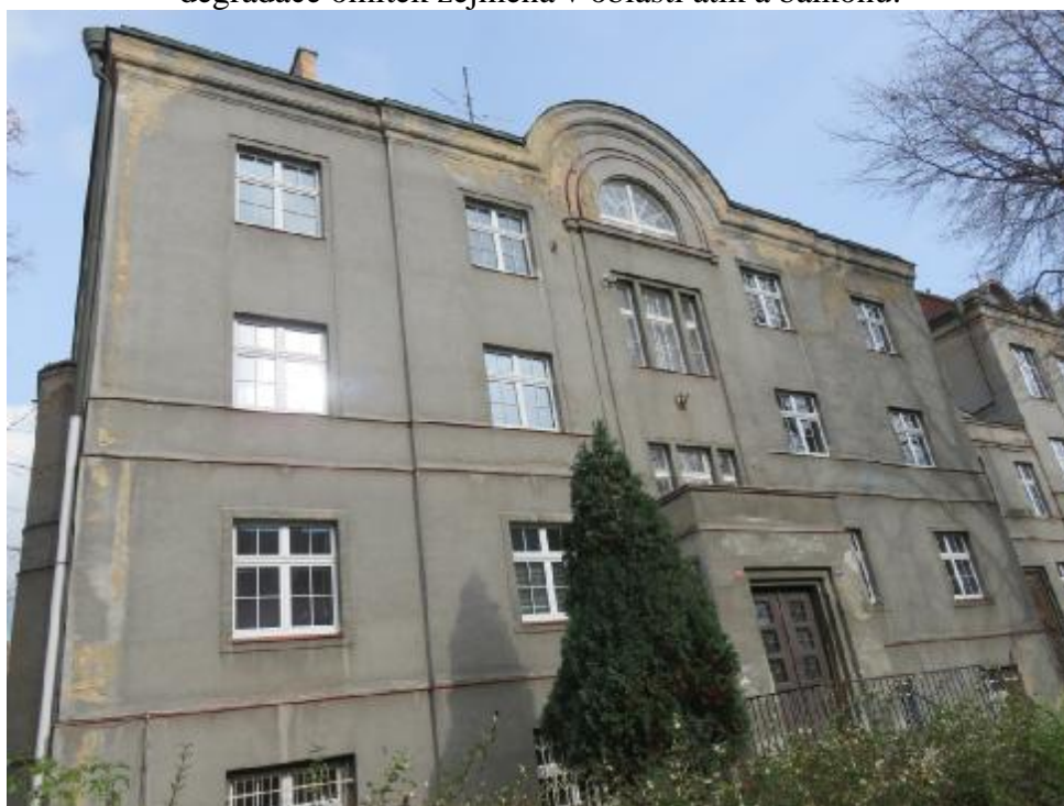
Foto 36: Jižní strana: pohled na jižní fasádu, na fasádě jsou patrné stopy po zatékání, degradace omítek zejména v oblasti atik a svodů.
