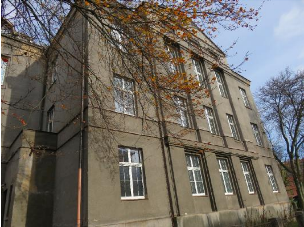
Foto 5: Jižní strana: pohled na jižní fasádu, na fasádě jsou patrné stopy po zatékání, degradace omítek zejména v oblasti atik.
