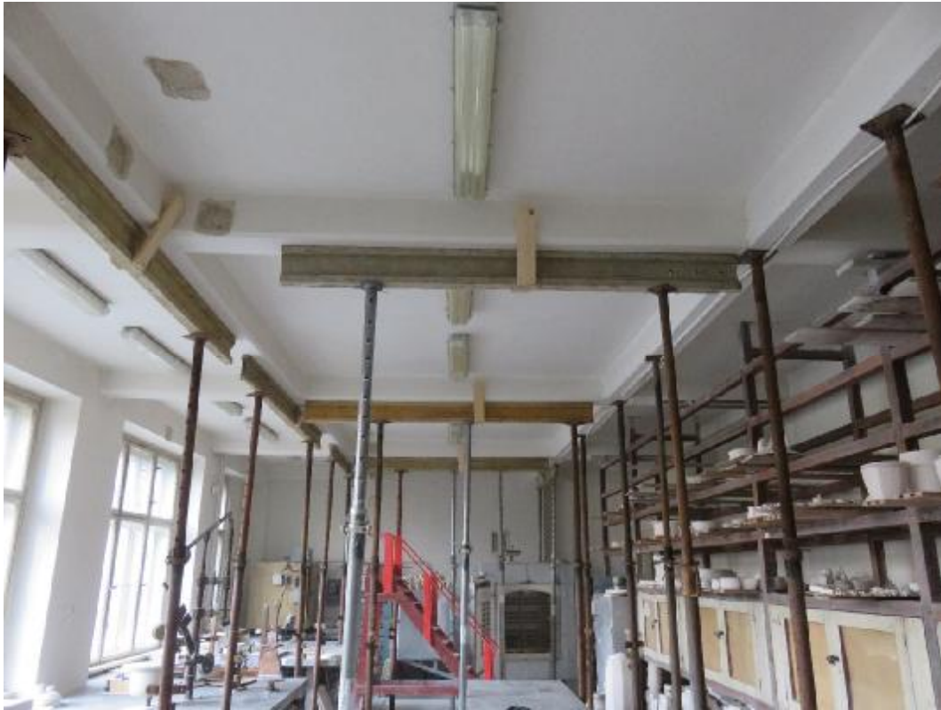
Foto 9: Hlavní budova 1.NP, místnost M1: viditelný průhyb stropní konstrukce cca 30 až 40 mm.
