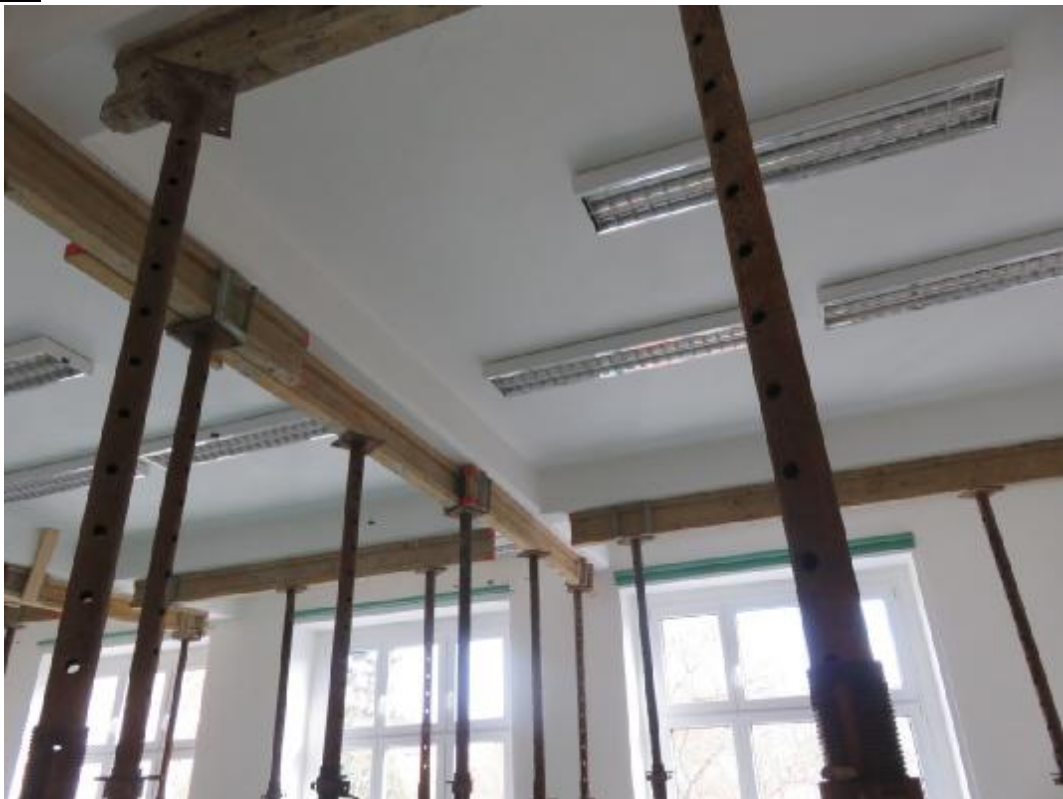
Foto 32: Hlavní budova 3.NP, místnost M2: viditelný průhyb stropní konstrukce cca 20 až 30 mm.
