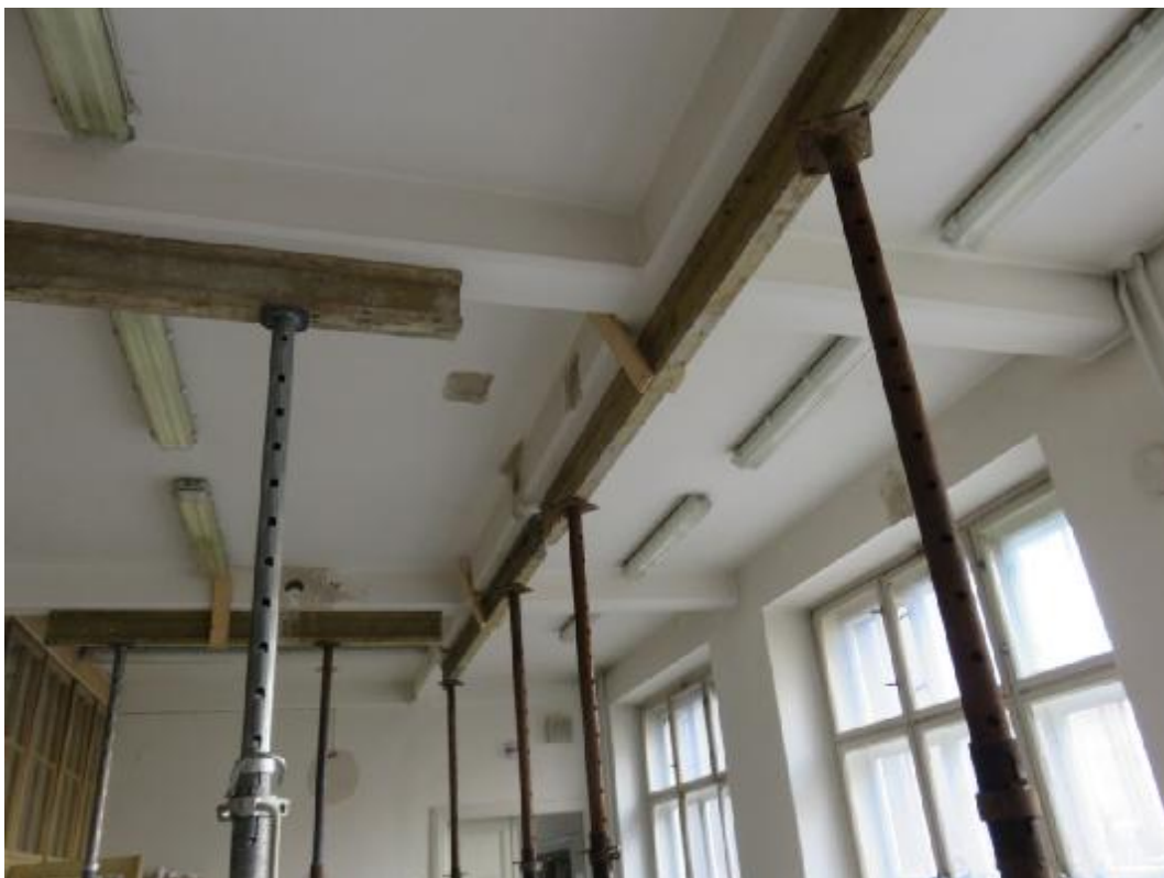
Foto 10: Hlavní budova 1.NP, místnost M1: viditelný průhyb stropní konstrukce cca 30 až 40 mm.
