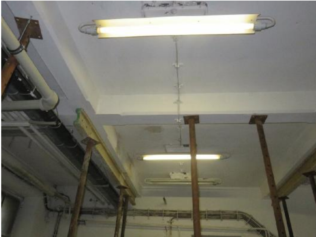
Foto 7: Hlavní budova 1.PP, místnost M1: viditelný průhyb stropní konstrukce cca 20 mm.
