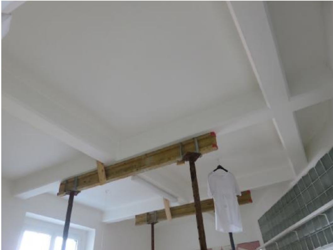
Foto 33: Hlavní budova 3.NP, místnost M3: viditelný průhyb stropní konstrukce cca 20 až 30 mm.
