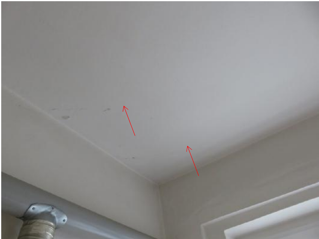
Foto 39: Bytový dům: 2x trhliny ve stropní desce šířky cca 0,2 až 0,3 mm.
