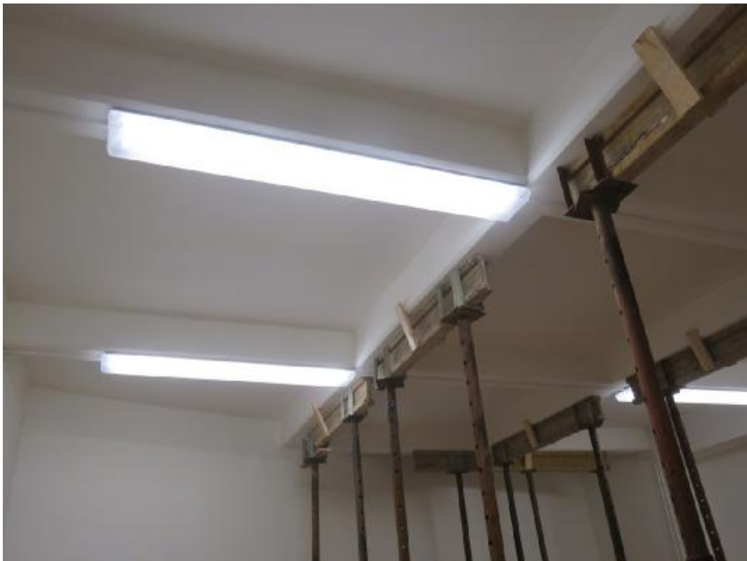
Foto 28: Hlavní budova 2.NP, místnost M2: viditelný průhyb stropní konstrukce cca 20 až 30 mm.
