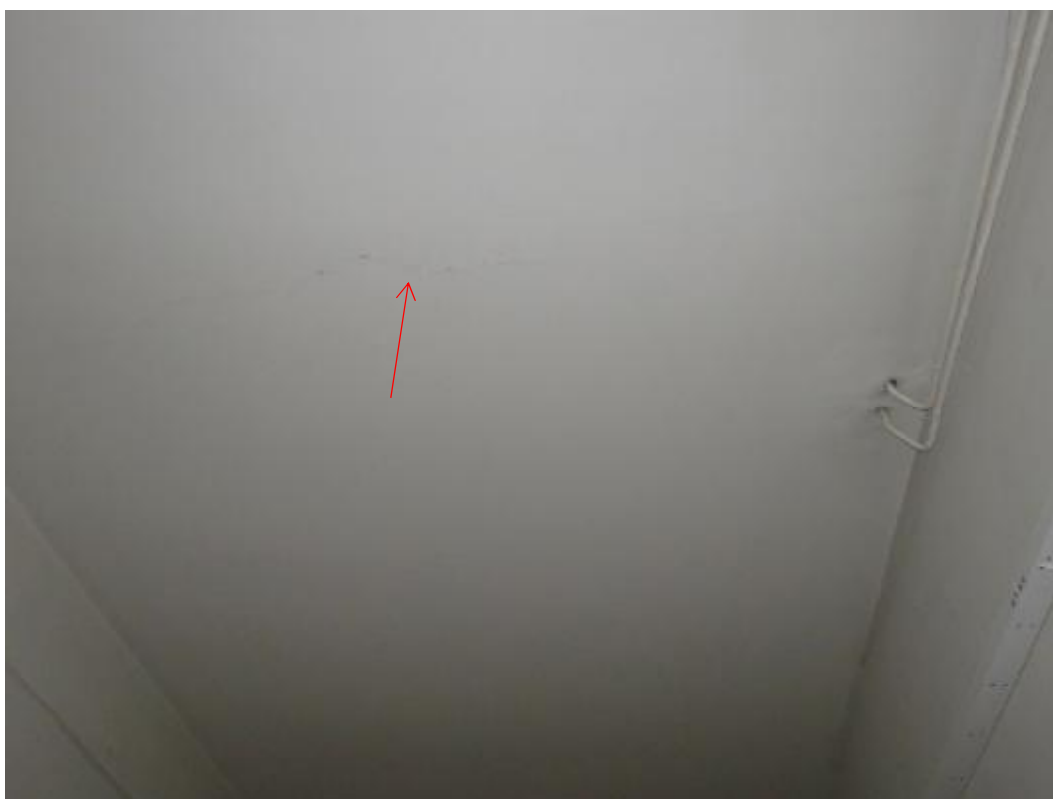
Foto 29: Hlavní budova 2.NP, chodba sever/jih: 3x trhlina ve stropní desce cca 0,5 mm.
