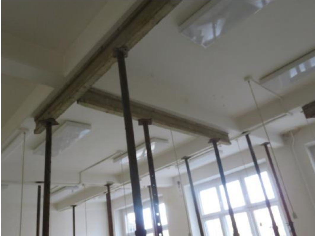
Foto 23: Hlavní budova 2.NP, místnost M1: viditelný průhyb stropní konstrukce cca 20 až 30 mm.
