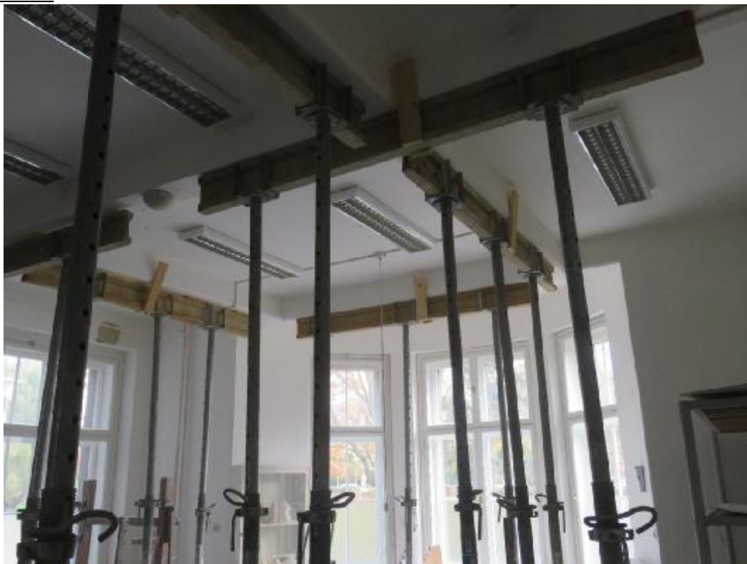
Foto 21: Hlavní budova 1.NP, místnost M3: viditelný průhyb stropní konstrukce cca 30 až 40 mm.
