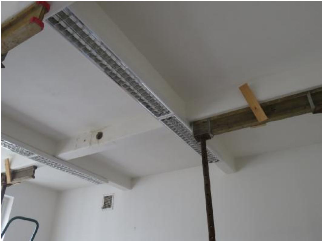
Foto 25: Hlavní budova 2.NP, místnost M2: viditelný průhyb stropní konstrukce cca 20 až 30 mm.
