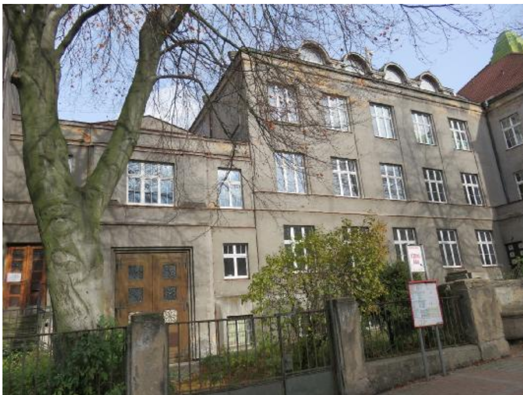
Foto 4: Jižní strana: pohled na jižní fasádu, na fasádě jsou patrné stopy po zatékání, degradace omítek zejména v oblasti atik.
