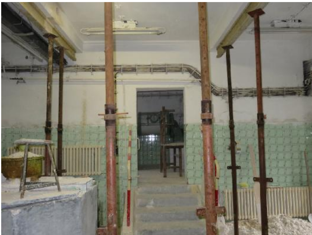
Foto 8: Hlavní budova 1.PP, místnost M1: viditelný průhyb stropní konstrukce cca 20 mm.
