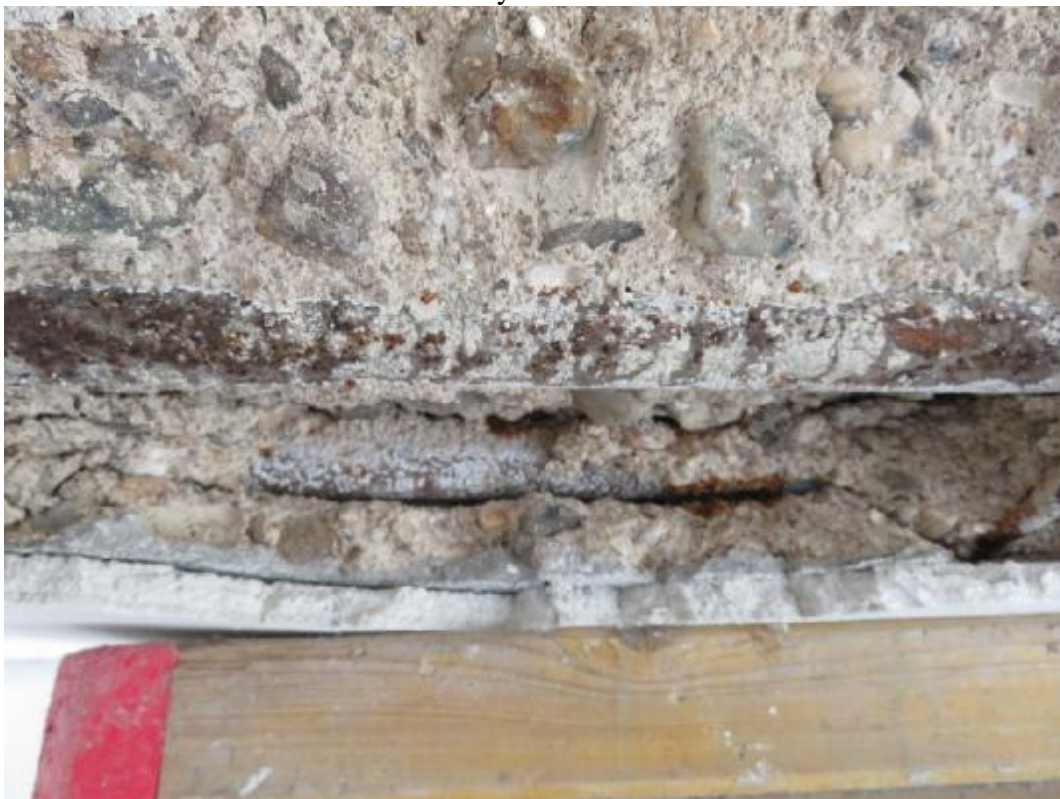
Foto 16: Hlavní budova 1.NP, místnost M2: trhliny na spodním líci středu tránu cca 3 až 4 mm. Trhliny oddělují krycí vrstvu betonu od výztuže, beton samovolně vypadává, povrchová koroze výztuže.
