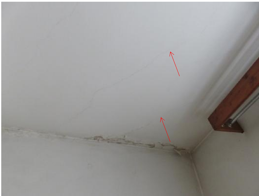
Foto 37: Bytový dům: 2x trhliny ve stropní desce šířky cca 0,2 až 0,3 mm.
