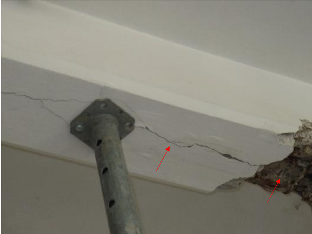
Foto 13: Hlavní budova 1.NP, místnost M2: trhliny na spodním líci středu tránu cca 3 až 4 mm. Trhliny oddělují krycí vrstvu betonu od výztuže, beton samovolně vypadává, povrchová koroze výztuže.
