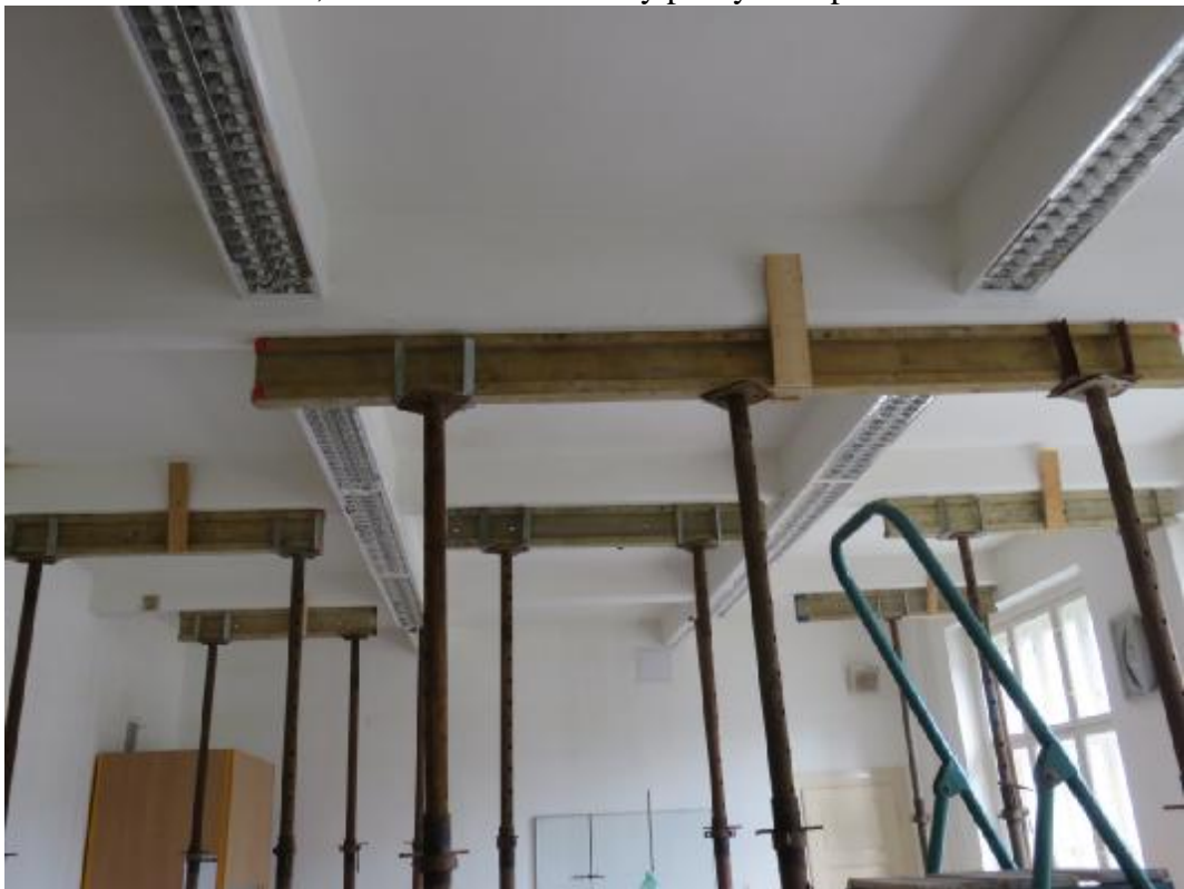
Foto 26: Hlavní budova 2.NP, místnost M2: viditelný průhyb stropní konstrukce cca 20 až 30 mm.
