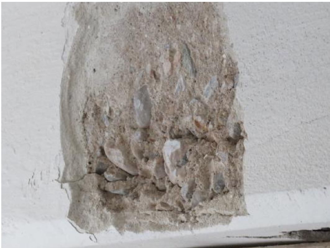
Foto 18: Hlavní budova 1.NP, místnost M2: trhliny na spodním líci středu tránu cca 3 až 4 mm. Trhliny oddělují krycí vrstvu betonu od výztuže.
