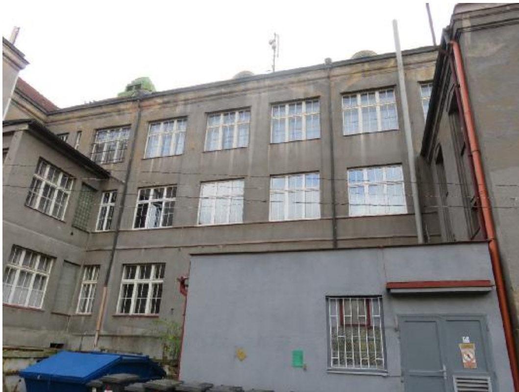
Foto 3: Severní strana: pohled na severní fasádu, na fasádě jsou patrné stopy po zatékání, degradace omítek zejména v oblasti atik.
