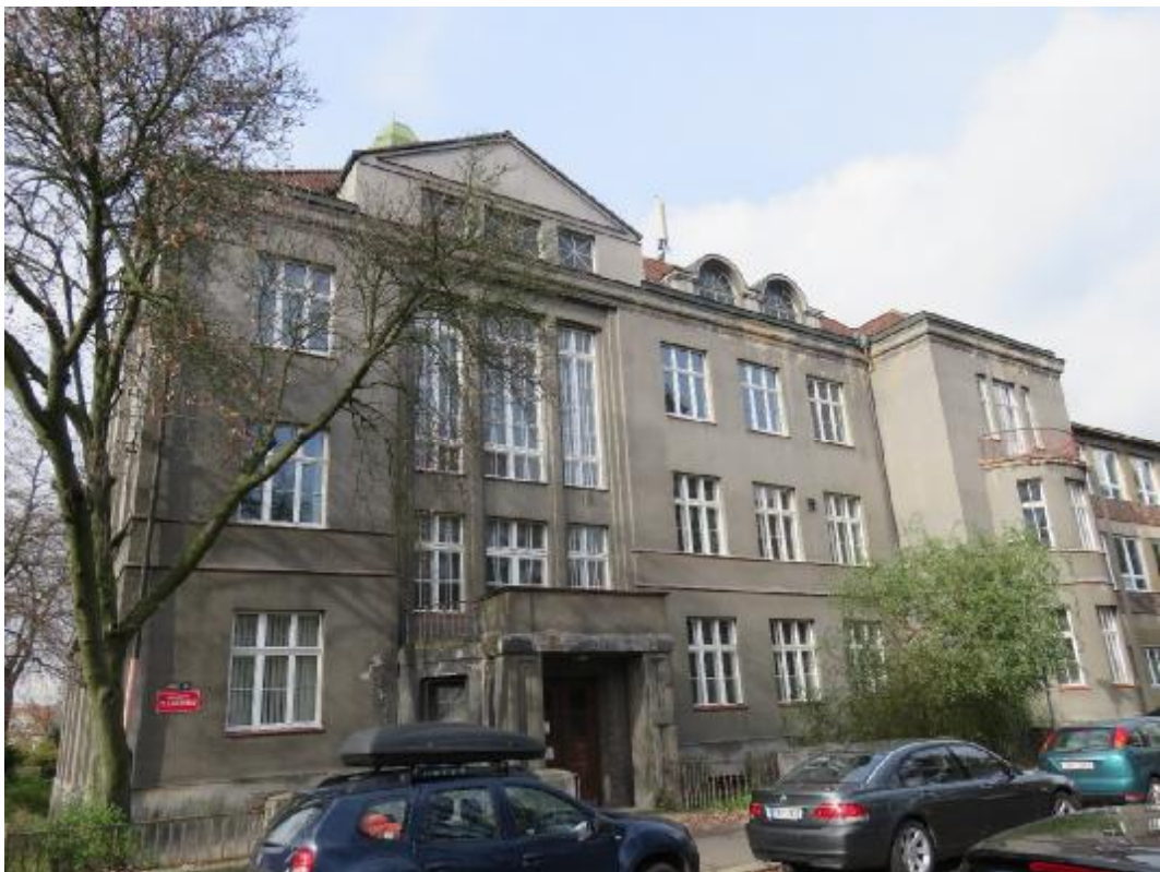
Foto 6: Východní strana: pohled na východní fasádu, na fasádě jsou patrné stopy po zatékání, degradace omítek zejména v oblasti atik.
