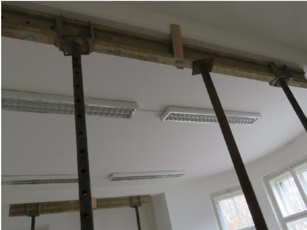
Foto 27: Hlavní budova 2.NP, místnost M2: viditelný průhyb stropní konstrukce cca 20 až 30 mm.
