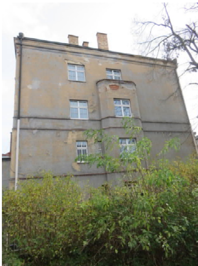
Foto 35: Západní strana: pohled na západní fasádu, na fasádě jsou patrné stopy po zatékání, degradace omítek zejména v oblasti atik a balkónu.
