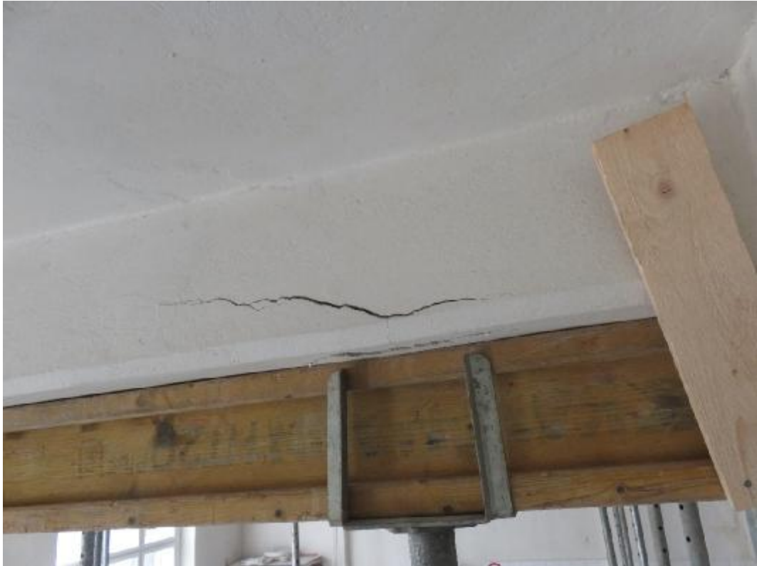
Foto 17: Hlavní budova 1.NP, místnost M2: trhliny na spodním líci středu tránu cca 3 až 4 mm. Trhliny oddělují krycí vrstvu betonu od výztuže.
