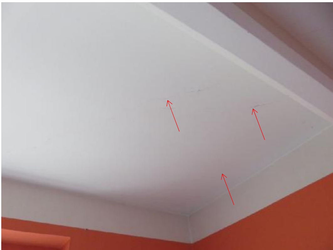
Foto 40: Bytový dům: 3x trhliny ve stropní desce šířky cca 0,2 až 0,3 mm.
