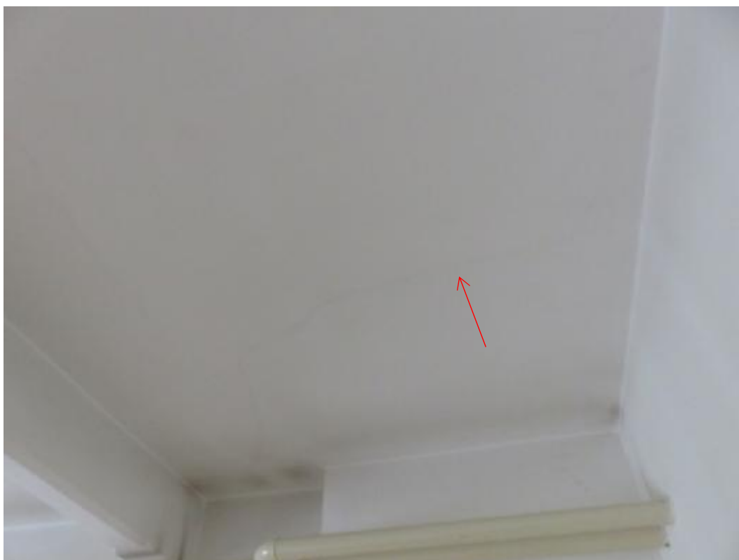
Foto 38: Bytový dům: 1x trhliny ve stropní desce šířky cca 0,2 až 0,3 mm.
