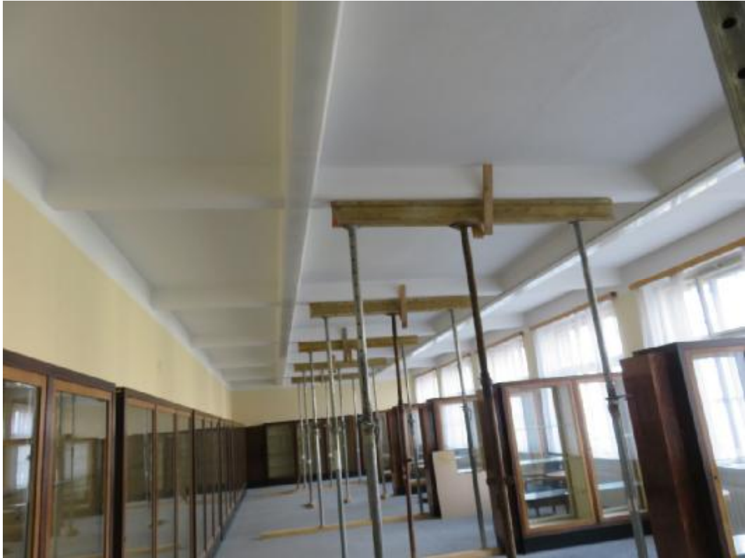
Foto 31: Hlavní budova 2.NP, místnost M1: viditelný průhyb stropní konstrukce cca 20 až 30 mm.
