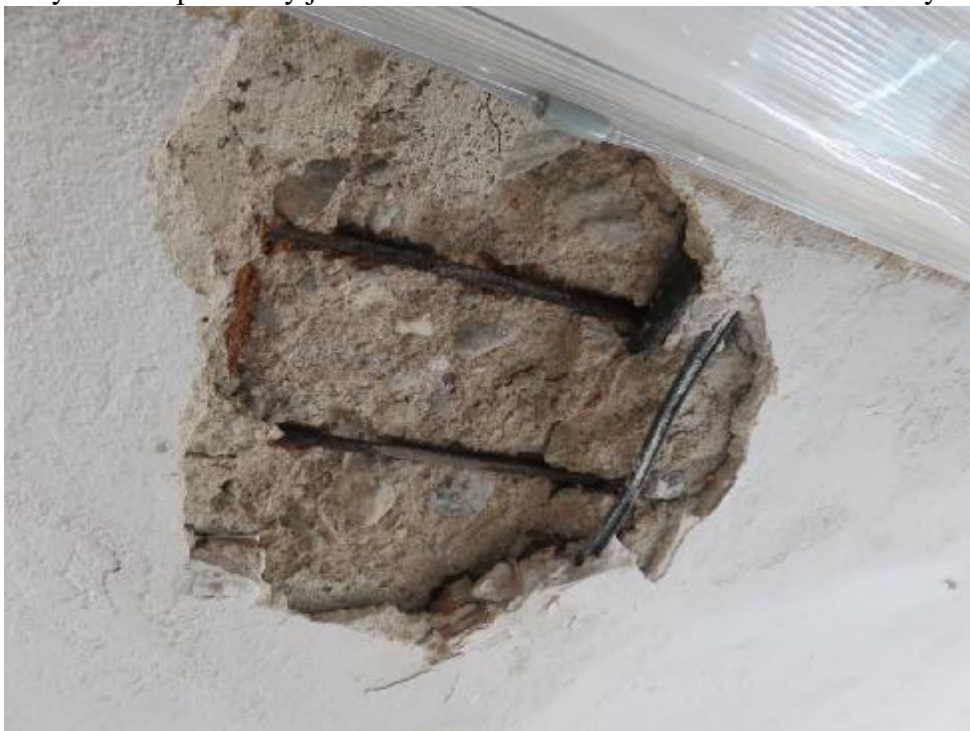
Foto 20: Hlavní budova 1.NP, místnost M2: v místě dlouhodobého zatékání z chemické laboratoře se odděluje krycí vrstva betonu, beton je v této oblasti silně degradován přes celou tloušťku stropní desky. Hlavní výztuž stropní desky je v této oblasti silně korodována s korozním úbytkem cca 30%.
