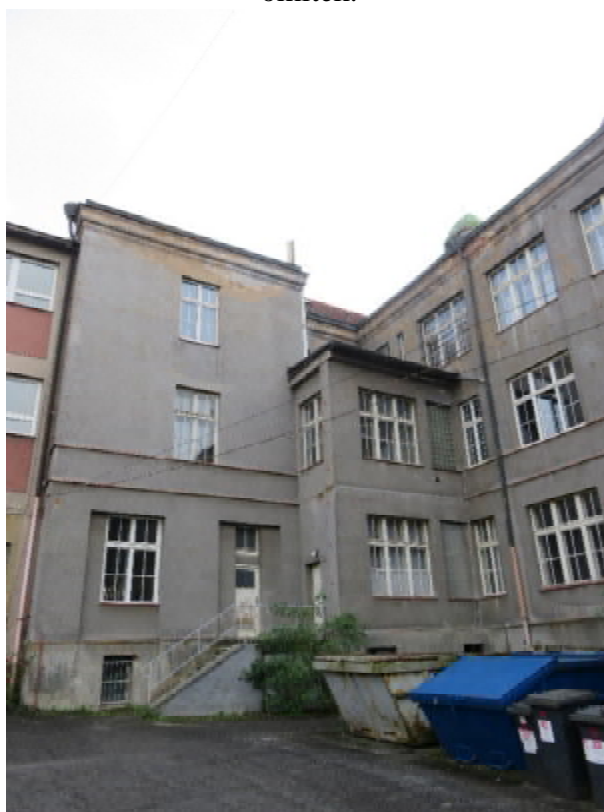
Foto 2: Západní strana: pohled na západní fasádu, na fasádě jsou patrné stopy po zatékání, degradace omítek zejména v oblasti atik.
