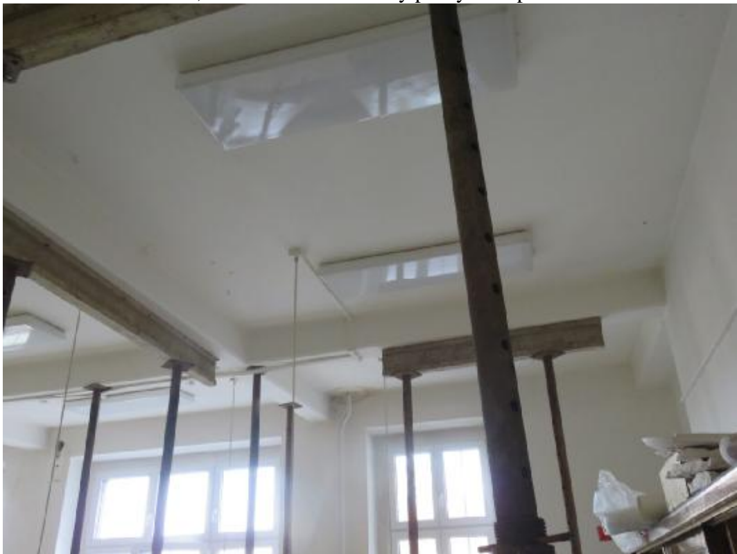
Foto 24: Hlavní budova 2.NP, místnost M1: viditelný průhyb stropní konstrukce cca 20 až 30 mm.
