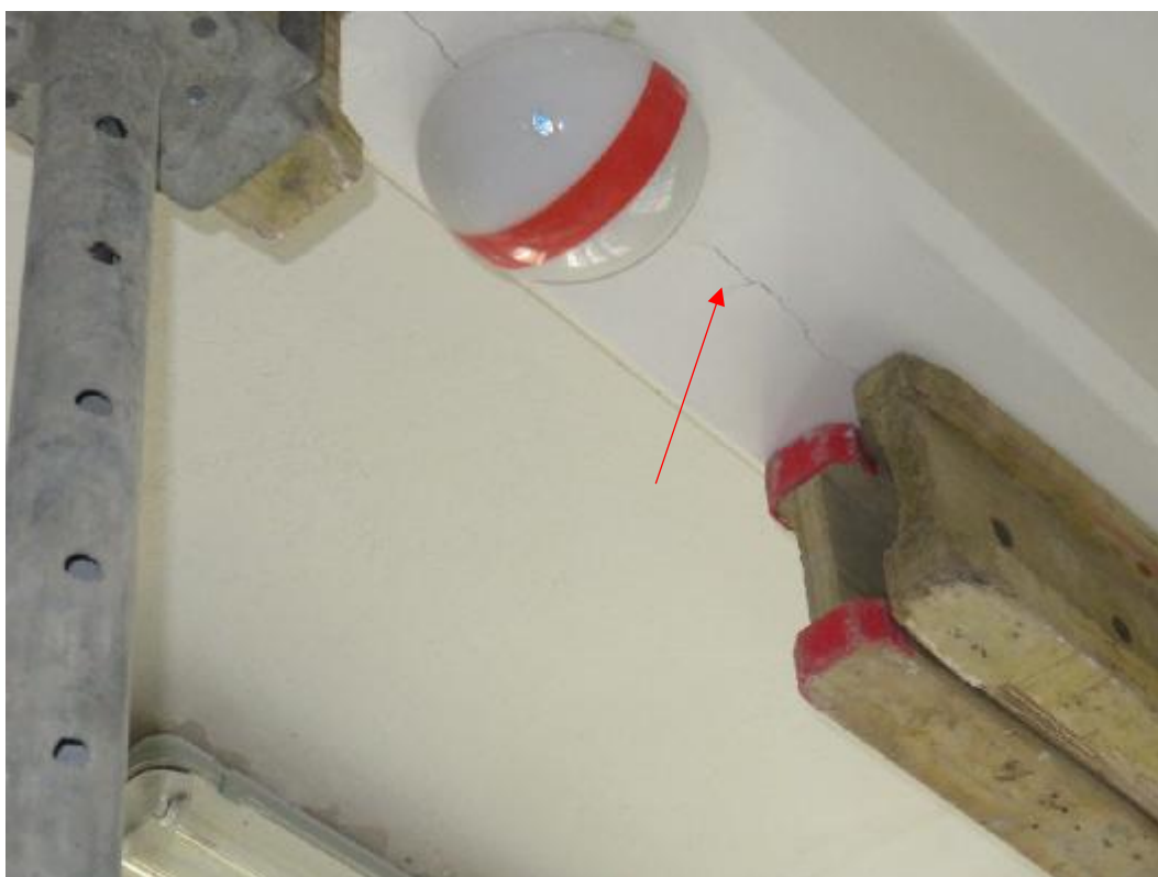
Foto 12: Hlavní budova 1.NP, místnost M2: trhлина na spodním líci středu tránu cca 3 až 4 mm.
