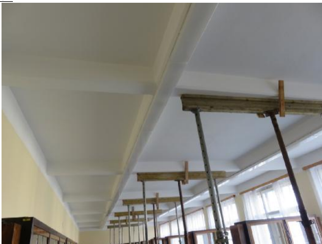
Foto 30: Hlavní budova 3.NP, místnost M1: viditelný průhyb stropní konstrukce cca 20 až 30 mm.
