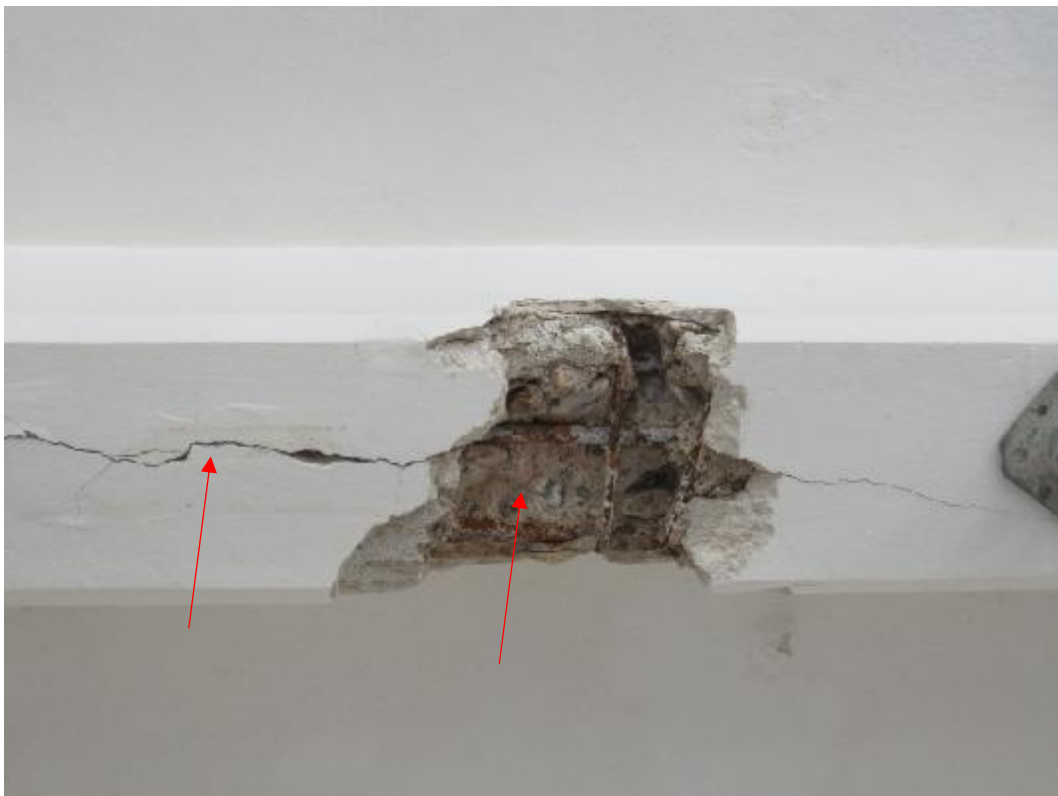
Foto 14: Hlavní budova 1.NP, místnost M2: trhliny na spodním líci středu tránu cca 3 až 4 mm. Trhliny oddělují krycí vrstvu betonu od výztuže, beton samovolně vypadává, povrchová koroze výztuže.
