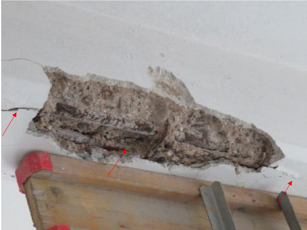
Foto 15: Hlavní budova 1.NP, místnost M2: trhliny na spodním líci středu tránu cca 3 až 4 mm. Trhliny oddělují krycí vrstvu betonu od výztuže, beton samovolně vypadává, povrchová koroze výztuže.
