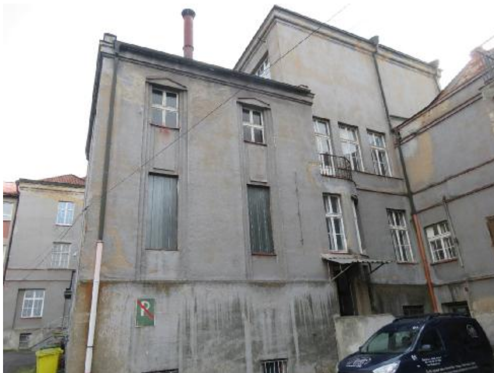
Foto 1: Západní strana: pohled na západní fasádu, na fasádě jsou patrné stopy po zatékání, degradace omítek.
