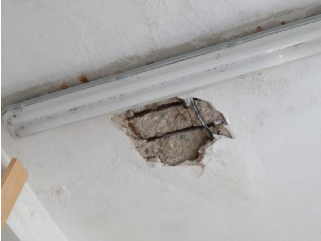
Foto 19: Hlavní budova 1.NP, místnost M2: v místě dlouhodobého zatékání z chemické laboratoře se odděluje krycí vrstva betonu, beton je v této oblasti silně degradován přes celou tloušťku stropní desky. Hlavní výztuž stropní desky je v této oblasti silně korodována s korozním úbytkem cca 30%.
