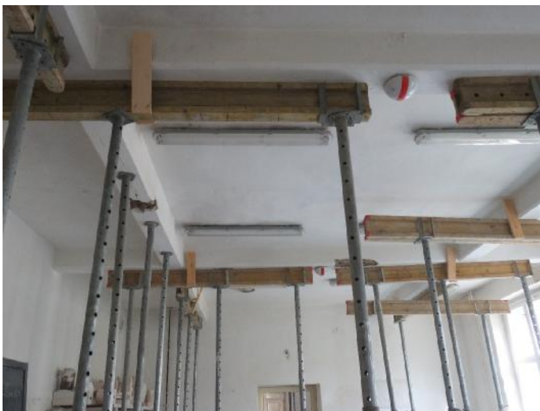
Foto 11: Hlavní budova 1.NP, místnost M2: viditelný průhyb stropní konstrukce cca 30 až 40 mm.
