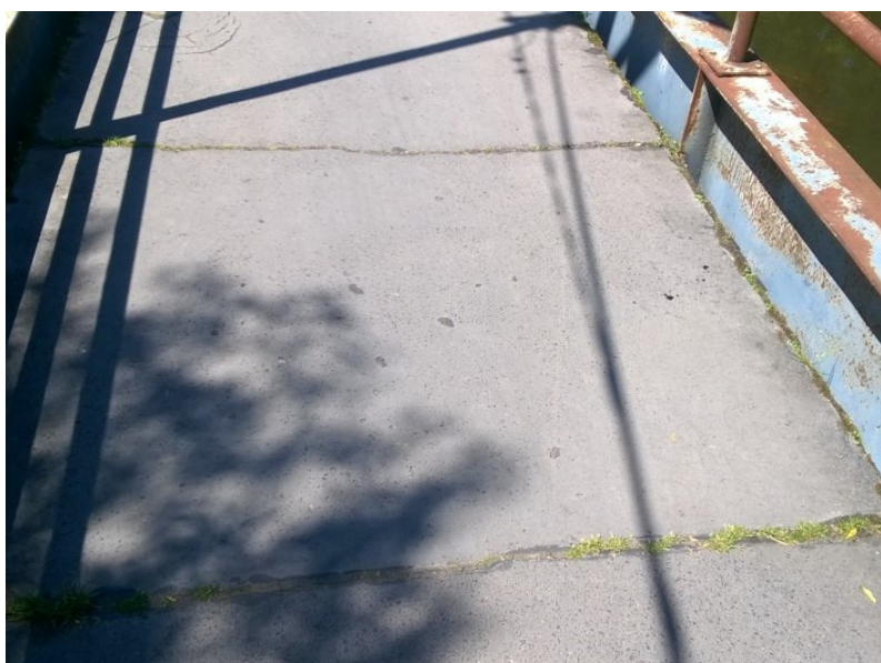
Trhliny ve vozovce
