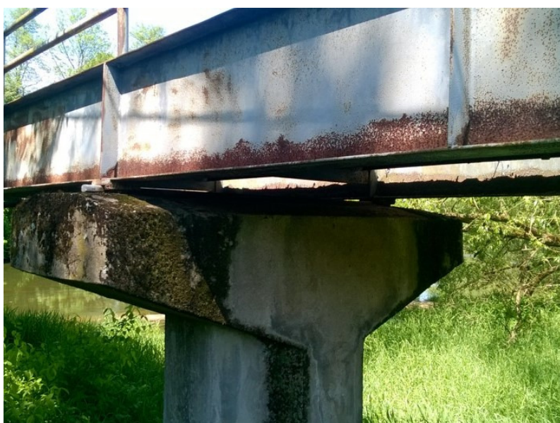
Koroze hlavních nosníků ve spodních částech, pohled na pilíř 2
