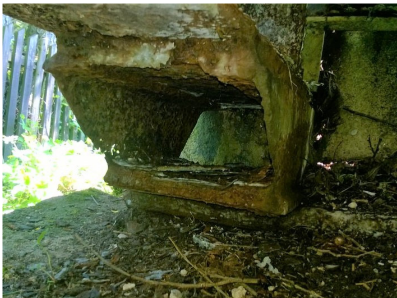
Rozpad ložiskového přípravku na opěře 1 vlevo
