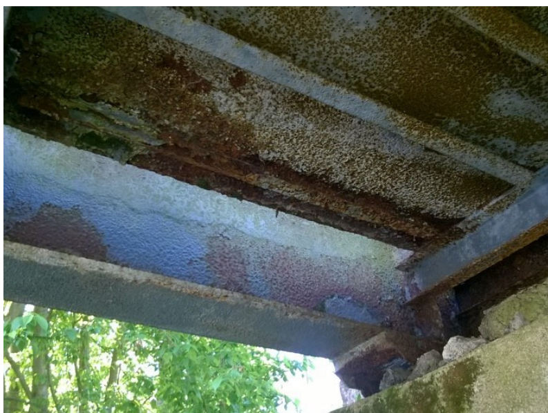
Rozpad podélných výztuh u opěry 5
