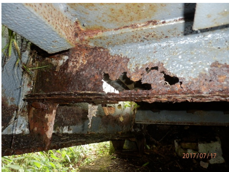
Rozpad příčníků u opěry 1
